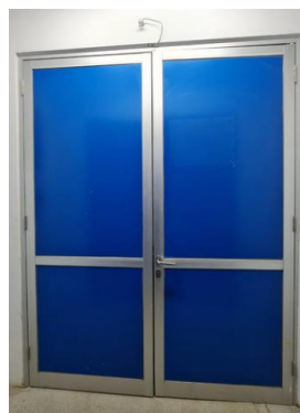
Gambar 15 Titik pemasangan sensor PIR HC-SR501 pintu A
