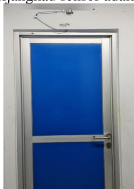
Gambar 17 Titik pemasangan sensor PIR HC-SR501 pintu C
