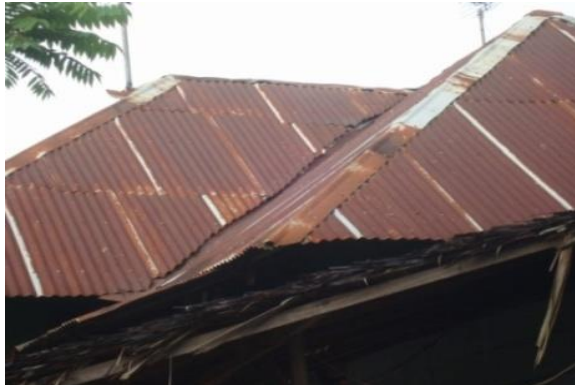
Gambar 3. Korosi atmosferik pada atap rumah
