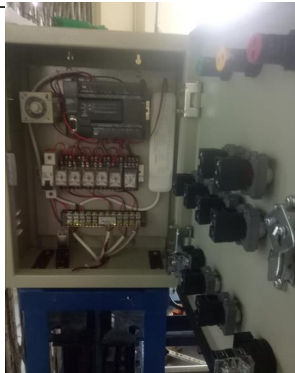
Gambar 6. Panel bagian dalam sistem kontrol mesin press biobriket hasil refabrikas
