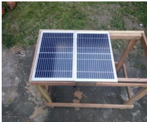
Gambar 5. Modul Surya terpasang pada Frame
