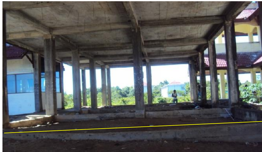
Gambar 6. Retak lentur pada balok
