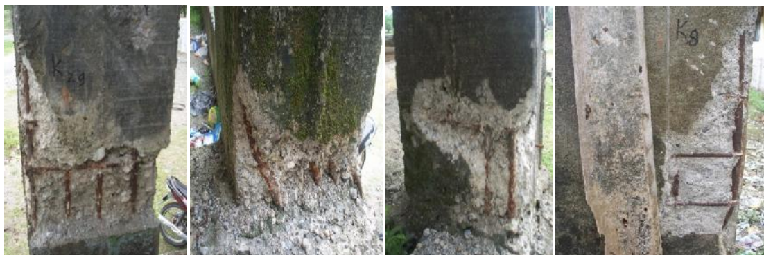
Gambar 7. Kondisi kolom mengalami pengapuran
