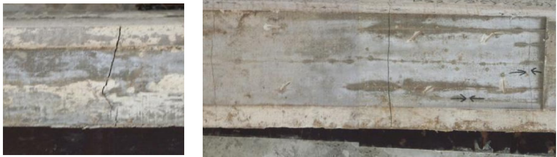
Gambar 8. Kondisi retak pada balok
