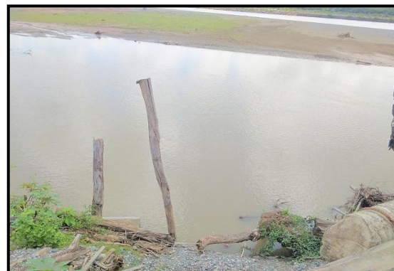
Gambar 6. Kondisi Sedimentasi pada Sungai Akibat Gerusan
