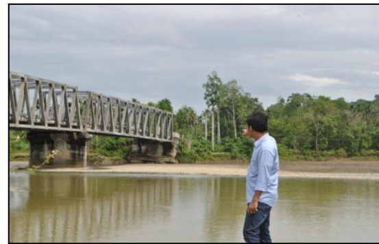
Gambar 4. Kondisi Terjadinya Penurunan Pondasi dan Miringnya Abutment
