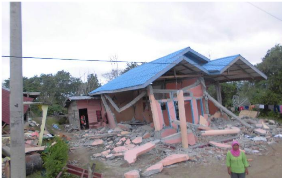
Gambar 2 Rumah Rusak Berat
