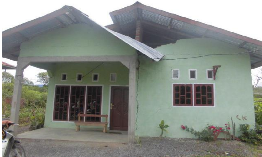
Gambar 3 Rumah Rusak sedang
