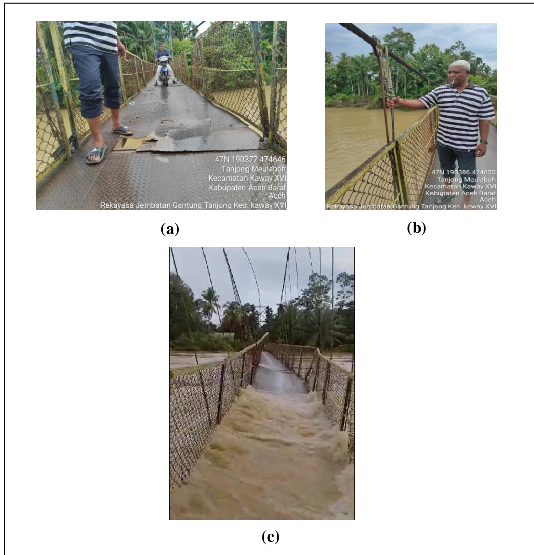
Gambar 1. Peninjauan Jembatan Gantung di Desa Tanjung Meulaboh: (a) Kerusakan lantai jembatan; (b) Kerusakan Gantungan jembatan; (c) Bencana Banjir
